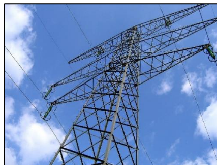
Figure 83 – Ligne à haute tension
